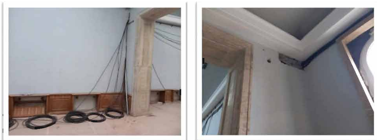
СМР в процес на изпълнение в ХГ „Борис Денев” – гр. Велико Търново
