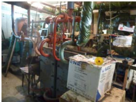
Сутерен – Абонатна станция във вход Б
