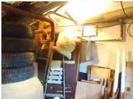
Сутерен – Абонатна станция във вход Б
